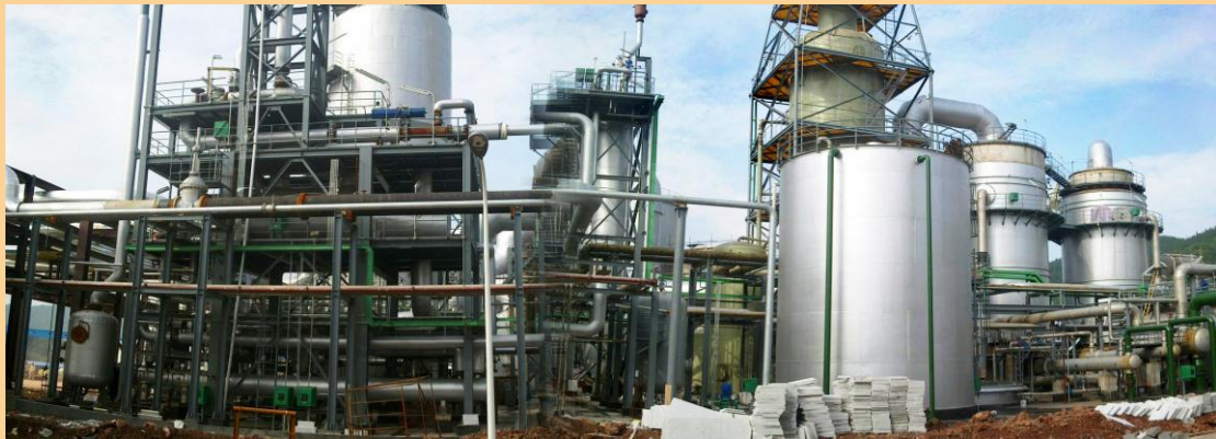
威顿达州化工有限公司 80 万吨/年硫磺制酸 HRS 总承包 0.8 Million tons /year Sulfuric Acid with HRS of Weidun Dazhou Chemical Co.,Ltd
