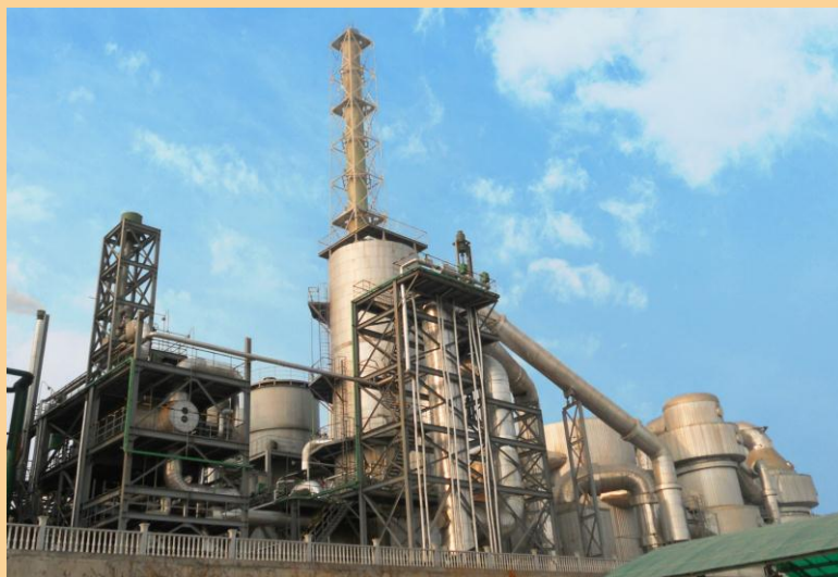
湖北三宁化工股份有限公司 80万吨/年硫酸装置 0.8 Million tons /year Sulfuric Acid of Hubei Sanning Chemical Co.,Ltd
