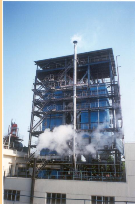
山东省泉林纸业 1200tds/d 碱回收燃烧工段工程 1200tds/d Alkali Recovery Boiler Combustion Workshop Section of Shandong Quanlin Paper
